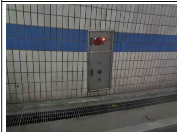
BOX구간 과천방향 부속시설 STA.020 소화기함 개폐불량
