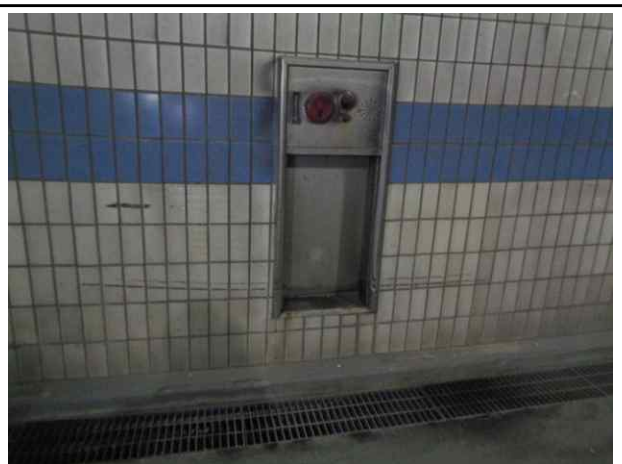
BOX구간 과천방향 부속시설 STA.095 소화기함 파손
