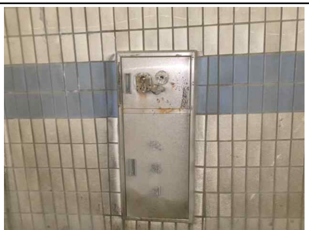
BOX구간 과천방향 부속시설 STA.450 소화기함 전등파손
